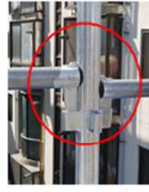
<안전난간 체결 불량(상태 재현)>
